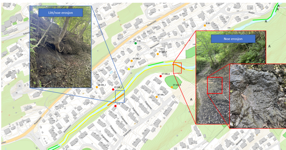
Figur 2: Pågående erosjon i Øverlandselva. Bildene er fra befaring i 2023 og viser vannmettede jordmasser som har glidd ut fra høyereliggende terreng. Tolkning av grunnundersøkelser med vekt på forekomst av sprøbruddmateriale er vist med ulike fargekoder (Vedlegg A og Kart 200).
